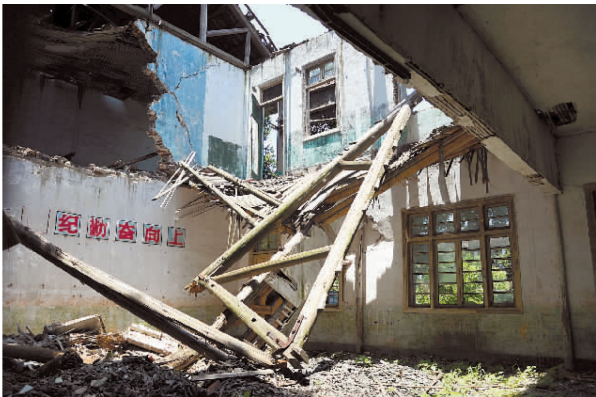
6月22日,记者在船山书院里看到,一栋两层楼房的屋顶和二楼地板已经垮塌。傅聪 摄
