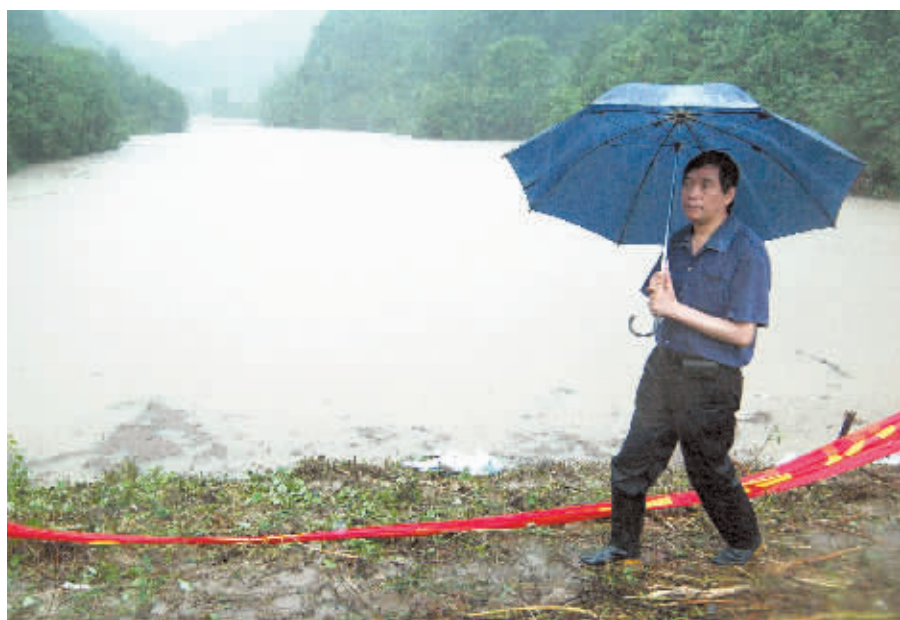
6月14日,临湘市白羊田镇秀只村,青坑水库外侧护坡完全垮塌,洪水现在离大坝最高处越来越接近。值班人员正在巡视堤坝上的情况。本版图片均由 记者 王翀 摄
