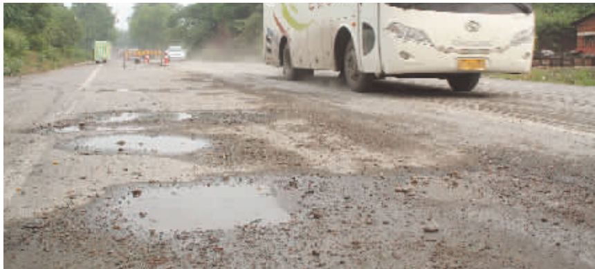
107国道1828KM处附近的2.7公里路段,路面出现很多坑洼。 徐德荣 摄
