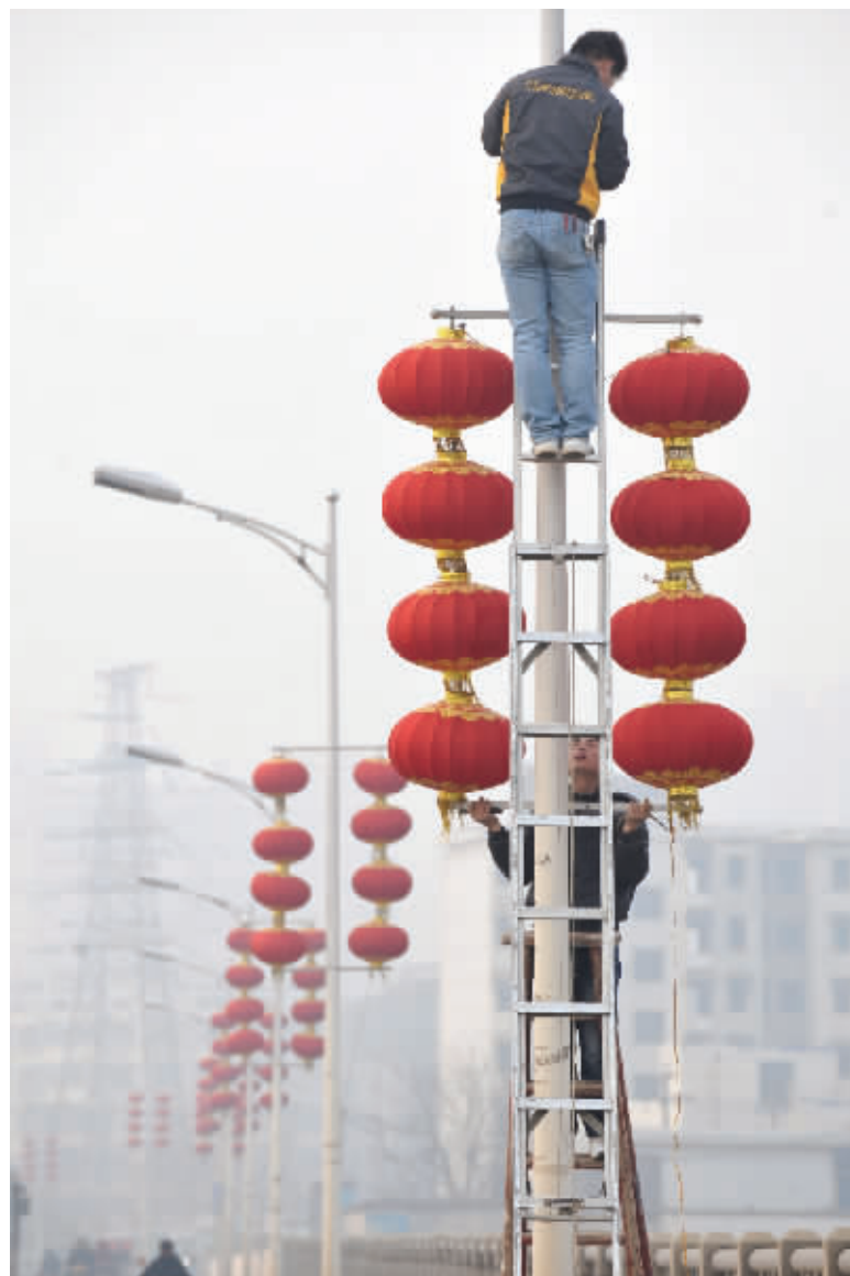
2月18日上午,长沙市芙蓉路浏阳河大桥,工作人员正在拆下红灯笼。
