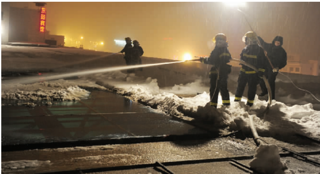
1月19日,长沙市汽车东站,春运第一天长沙迎来了40年来最大的一场雨雪。汽车东站候客大厅的玻璃天顶积雪过多不堪重负,有垮塌的危险。为确保旅客候车安全,车站管理部门向消防部门求援,清理屋顶积雪。 记者 伍霞 摄影报道
