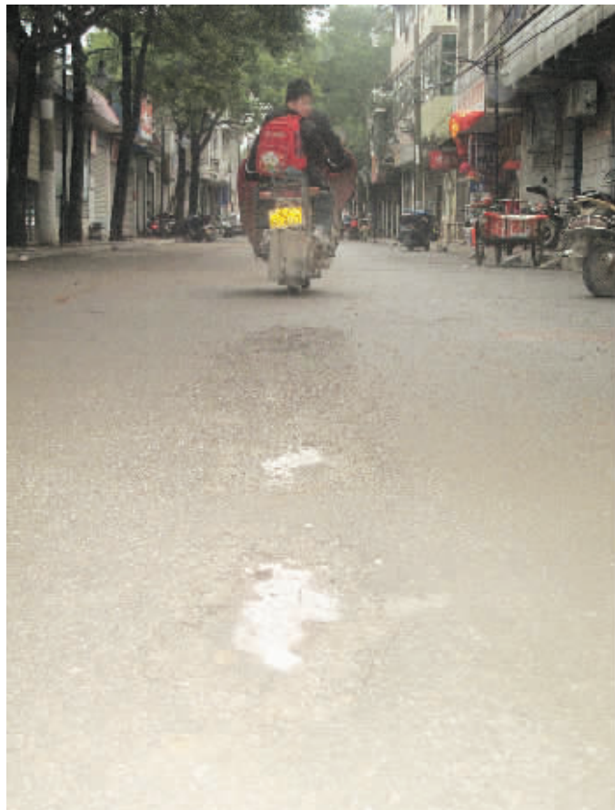
12月14日下午,湘潭市岳塘区下摄司半边街,这条路改造完工不到半个月就烂了。居民说,铺到路面上的沥青不到4厘米厚。
