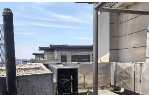
8月28日,长沙市雨花区建发央玺小区2栋顶层上餐馆加装的排油烟装置。
