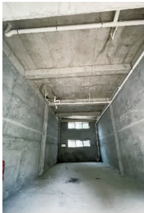
二樓業主將水管裝在一樓商舖室內。
