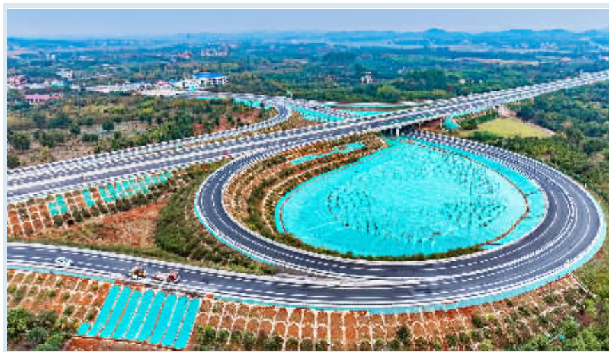
12月8日,永(州)新(宁)高速公路东安段,建设者正在进行扫尾施工。永新高速将于12月中旬通车。届时,永新高速与G59呼北高速、S85白新高速在湘南和桂北地区形成一条连接桂林、岚山、永州及衡阳的省际旅游黄金通道。 蔡小平 摄
