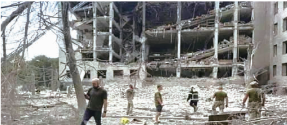
乌克兰波尔塔瓦州的一所军事学院遇袭后的建筑废墟。图/央视新闻
