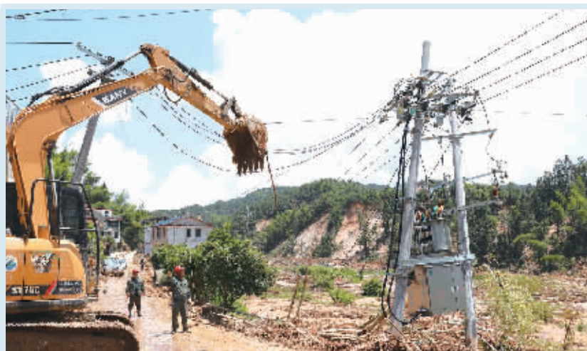
8月6日，工人在资兴市州门司镇白筱村抢修供电设施设备。连日来，资兴市协调各方力量，抓紧抢修因灾受损的水、电、路等基础设施，切实保障受灾群众基本生活，加快恢复生产生活秩序。
