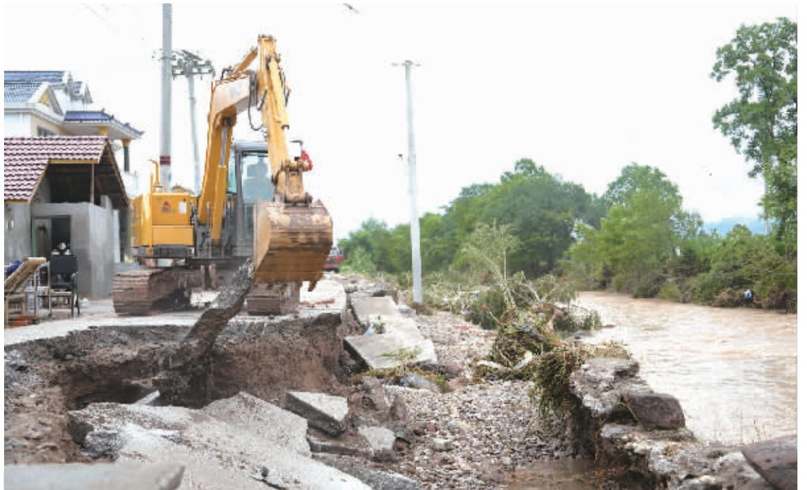
6月23日,在茶庵寺镇三元潭村,挖掘机在处理路基被洪水冲垮的村道。日前,位于湖南省西北部的常德市桃源县茶庵铺镇因强降雨造成山洪暴发,水毁严重。 新华社图
