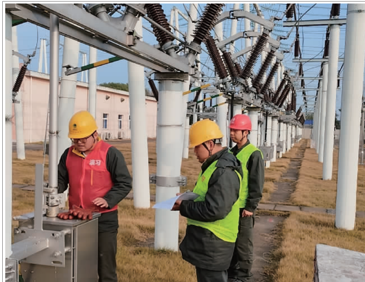
12月18日，国网湘潭供电公司220千伏景源变电站开展迎峰度冬专业化巡视，对主变油温、油位、站内加热驱潮装置、开关柜防潮凝露以及融冰间隔运行情况进行排查，为极寒天气下可靠供电提供坚强保障。
