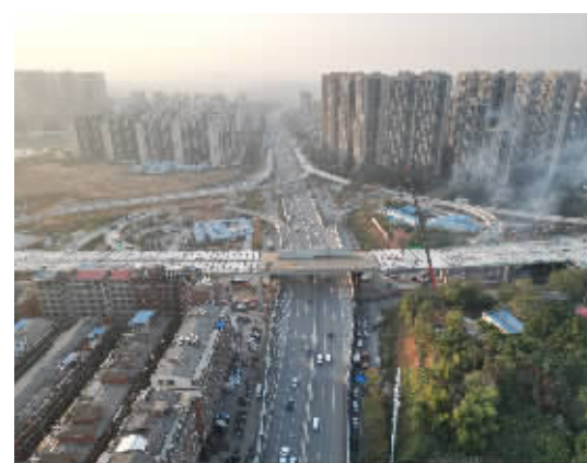
12月4日,在星沙联络线与万家丽路交会处,随着最后一块桥面板安全平稳地落位到钢梁上,标志着由中铁五局承建的万家丽路快速化改造北延线工程主线主体工程完工。
