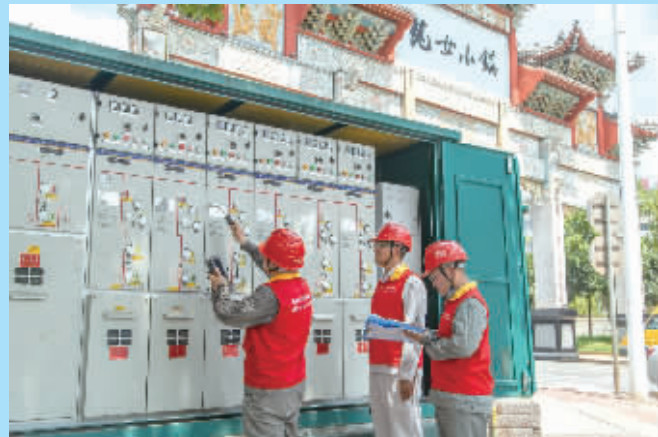
国网郴州供电公司员工在龙女小镇对 10 千伏配电环网柜进行局放检测。
