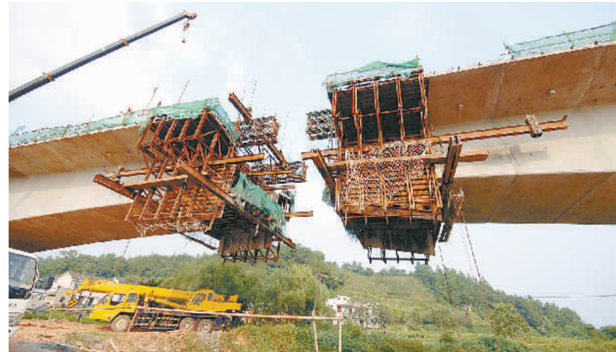
近日,中铁四局建设者在武广铁路客运专线长沙段洪塘村特大桥施工。我省加快铁路建设步伐,目前除武广客运专线外,洛湛铁路南段(永岑段)、洛张电气化铁路、长沙南北货场搬迁等在建设工程正在抓紧施工中。
