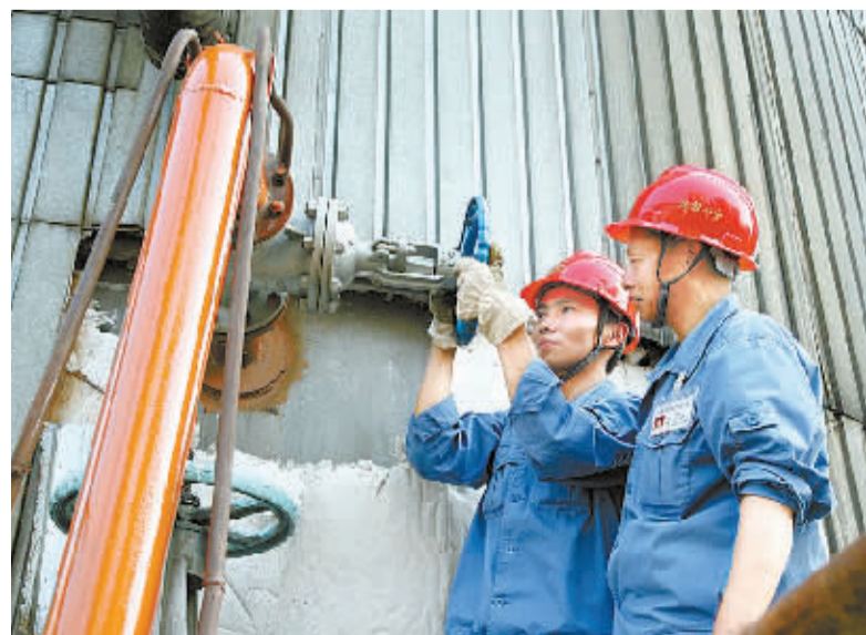
9月中旬,巴陵石化烯烃事业部“密闭式蒸汽冷凝水回收系统”改造投入使用后,每天回收190吨左右的蒸汽冷凝水,年节水效益将超过80万元。此举是巴陵石化节能减排系列措施之一。图为职工在新投用的蒸汽冷凝水回收系统现场调试和讨论优化操作事项。 彭展 摄
