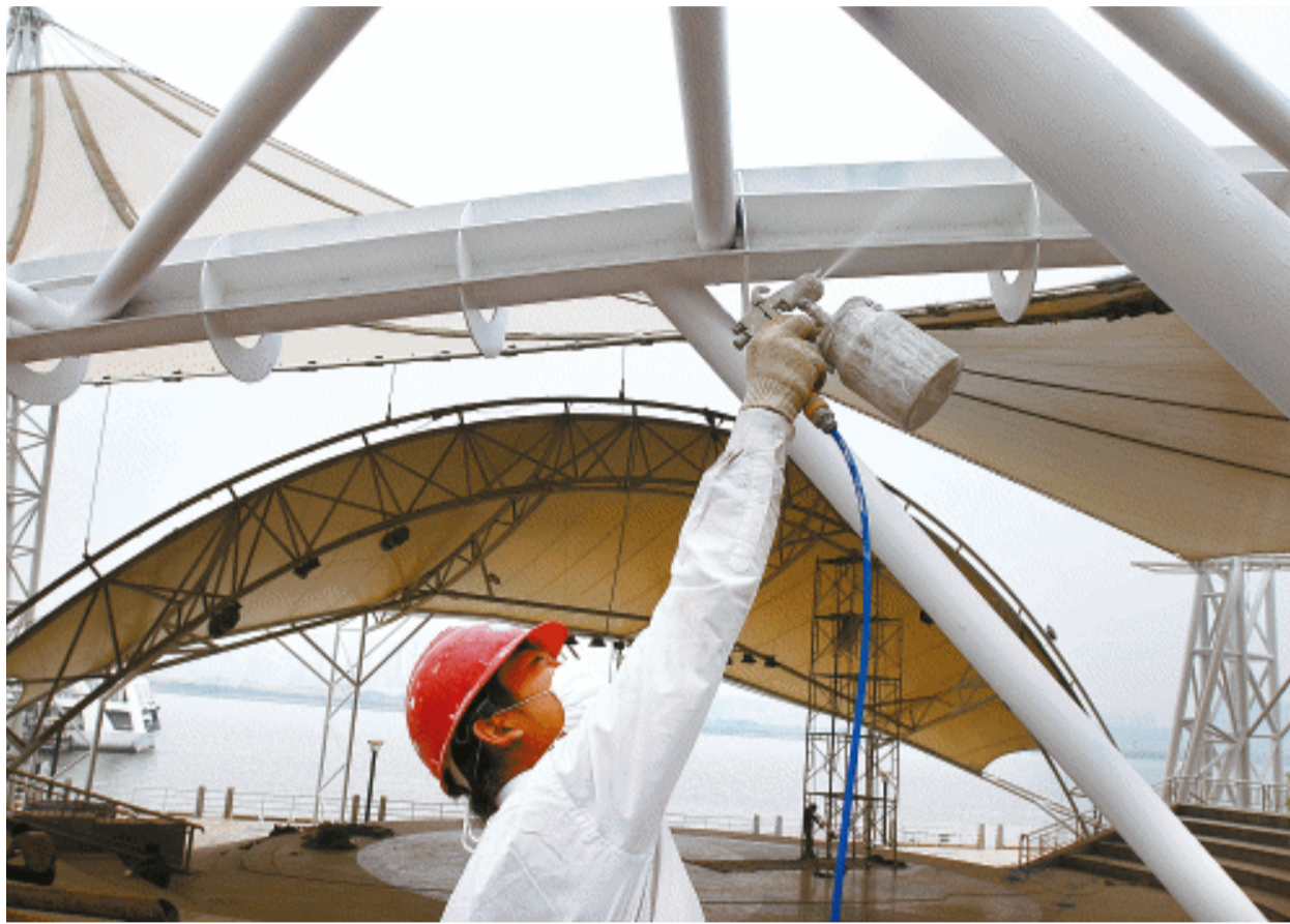
8月25日,长沙市湘江风光带风帆广场,施工人员在对接风帆支架进行最后的油漆喷涂。为迎接文明城市创建,风帆广场迎来建成以来的首次大规模整修,主要对风帆拉索钢轮廓进行加固,并重新粉刷油漆,完工后能抗12级大风。
