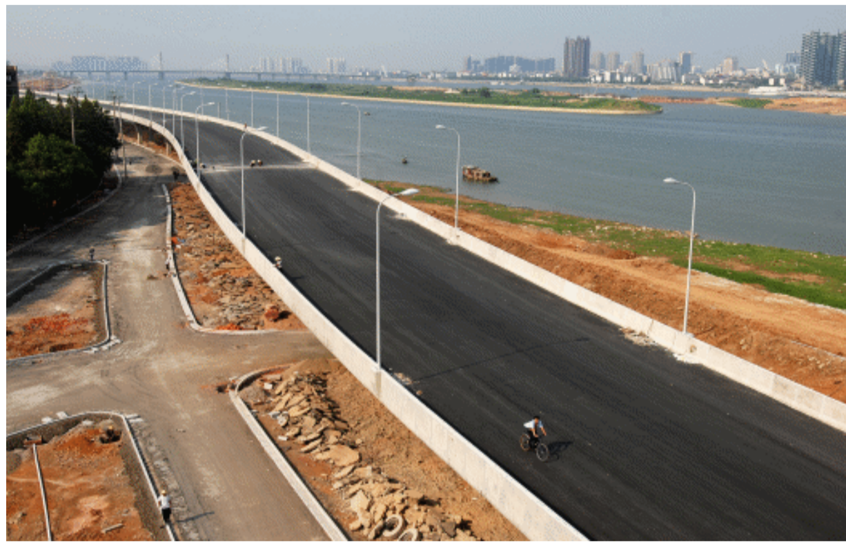
8月19日,长沙市岳麓区潇湘大道望月湖高架桥主体工程全面完工,施工人员进行最后的收尾工程。具有“长沙第一湾”之称的望月湖高架桥,将于本月底竣工通车。 本报记者 郭立亮 摄
