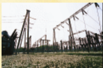
公司220KV 用户终端变电站
