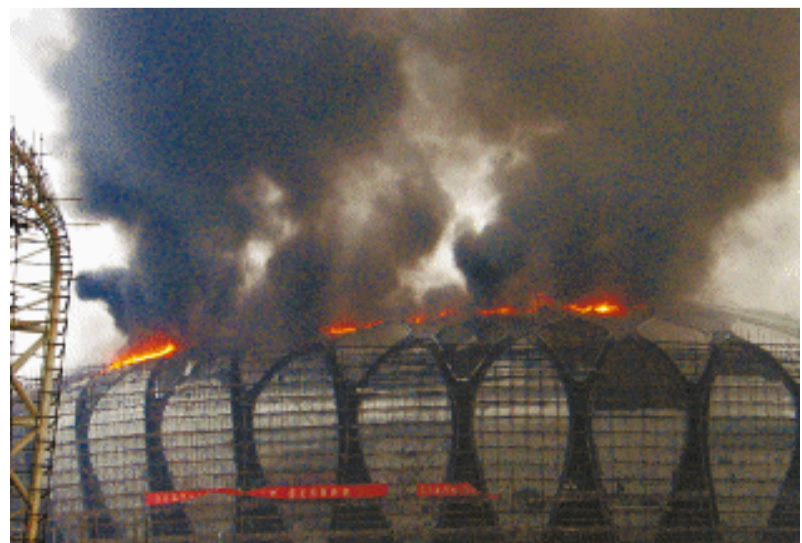
7月27日下午5时多，济南奥体中心在建球类体育馆发生火灾。22时左右大火基本熄灭。新华社发
