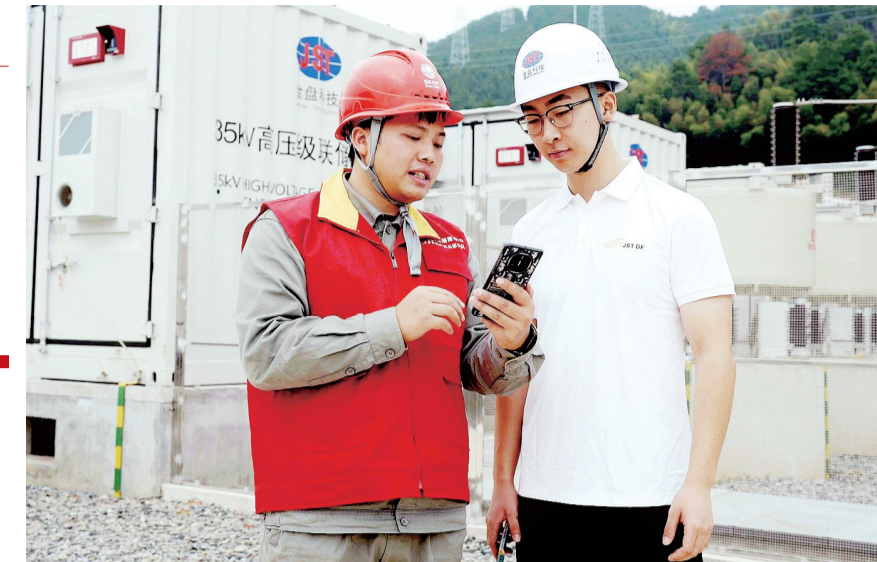
10月27日,邵阳供电公司员工在绥宁储能站走访。
