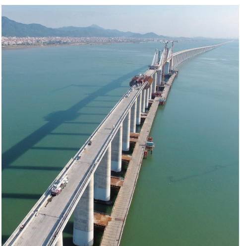
11月13日，新建福州（门）铁路湄洲湾跨海大桥成功合龙，该桥是国内首座跨海高铁矮塔斜拉桥。 新华社发
