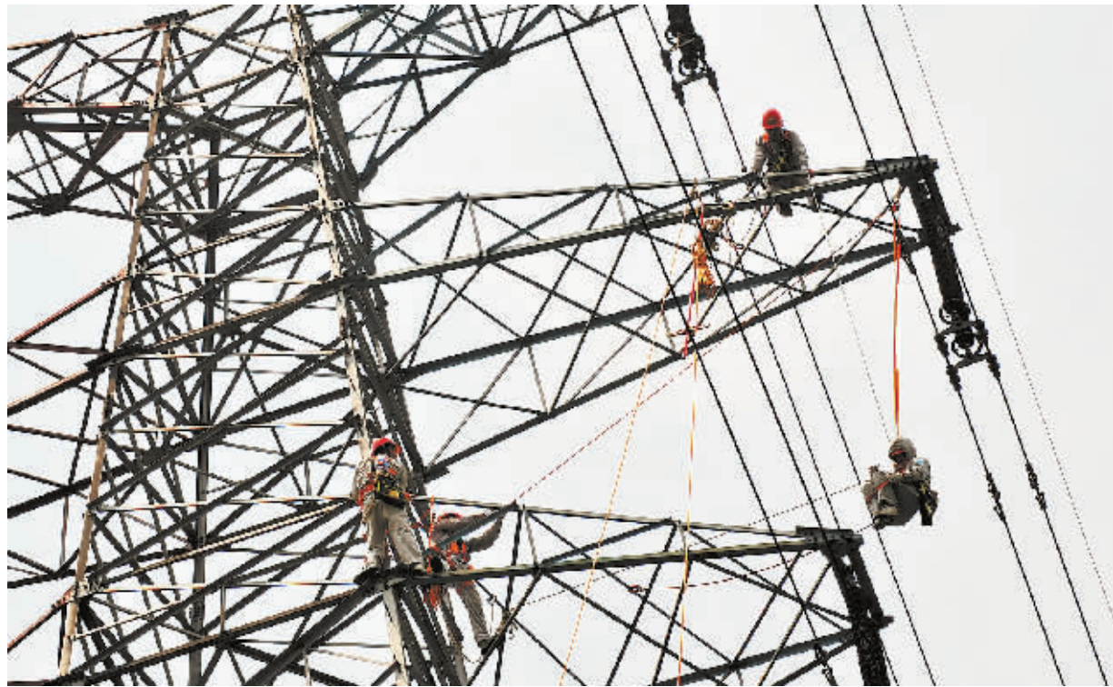
7月18日上午,长沙市边山森林公园附近,国网湖南带电作业中心几名抢修人员爬上50余米高的220千伏输电塔,带电更换出现故障的绝缘子。入夏以来,省电力公司在电网维护检修方面更多地采取带电作业方式,让电网持续稳定供电。
