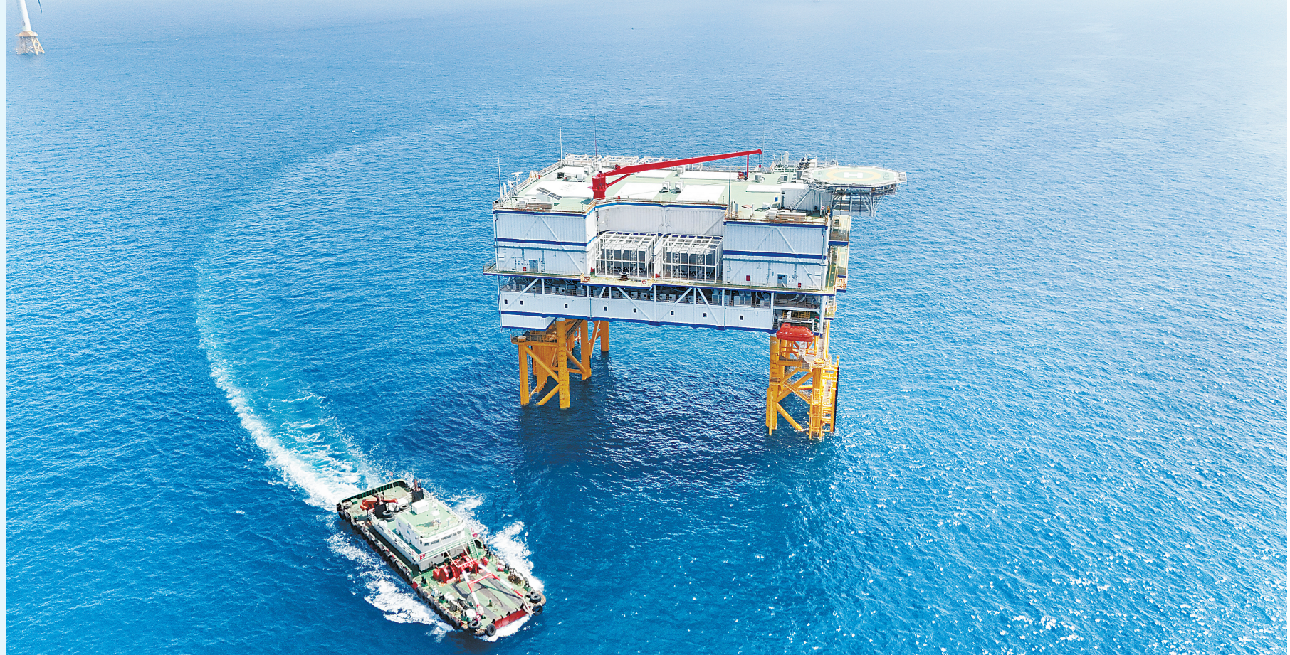
特变电工衡变公司承接的海上风电项目。
